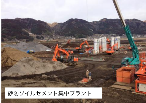
土石流後の砂防ソイルセメント堰堤
