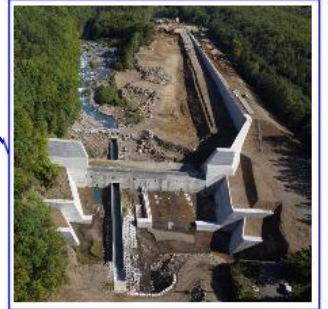
H24 美瑛川第1号導流堤
